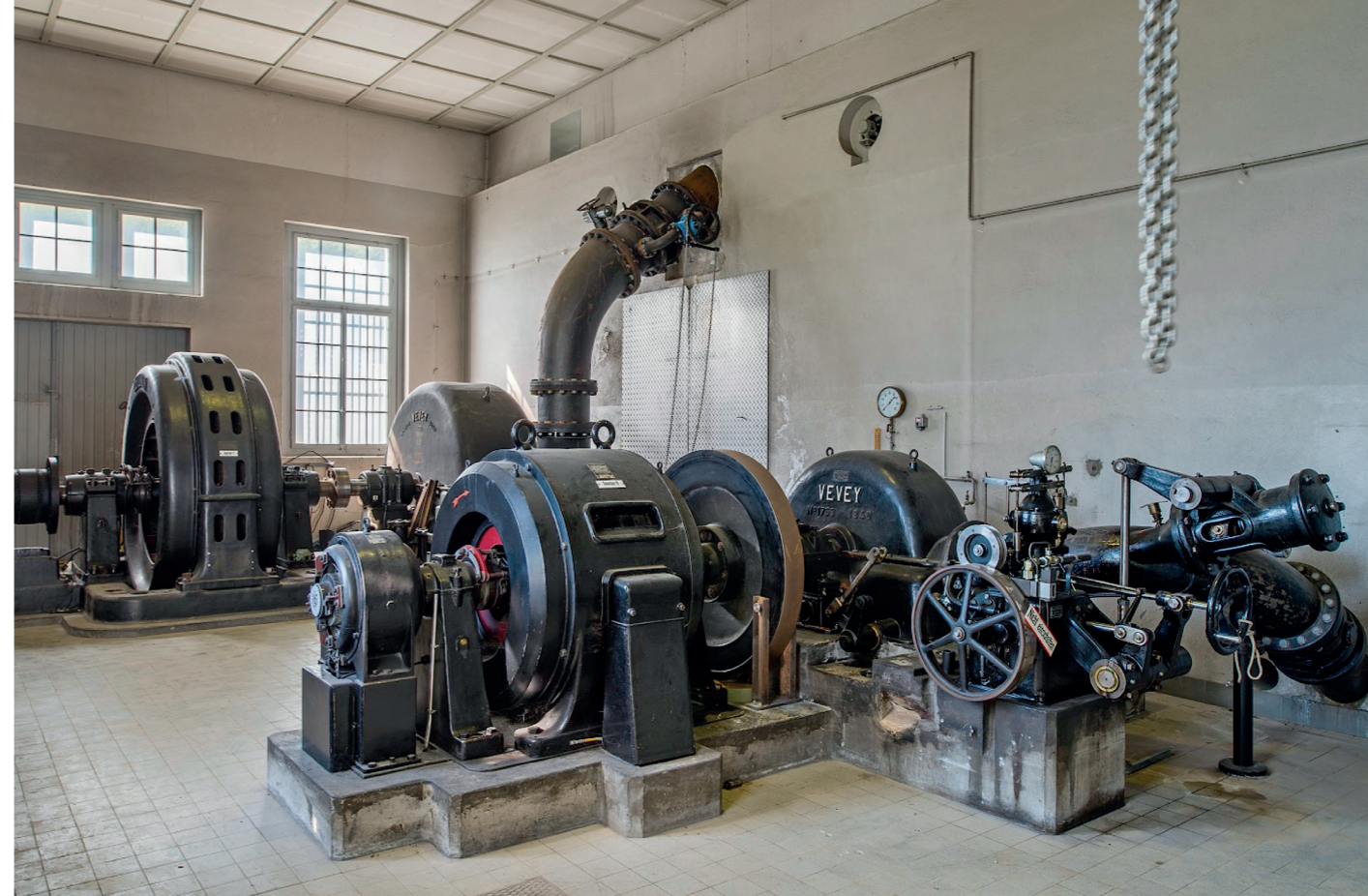
Das Gebäude des Kraftwerks Schattenhalb 2 beherbergt zwei Maschinengruppen bestehend aus:
